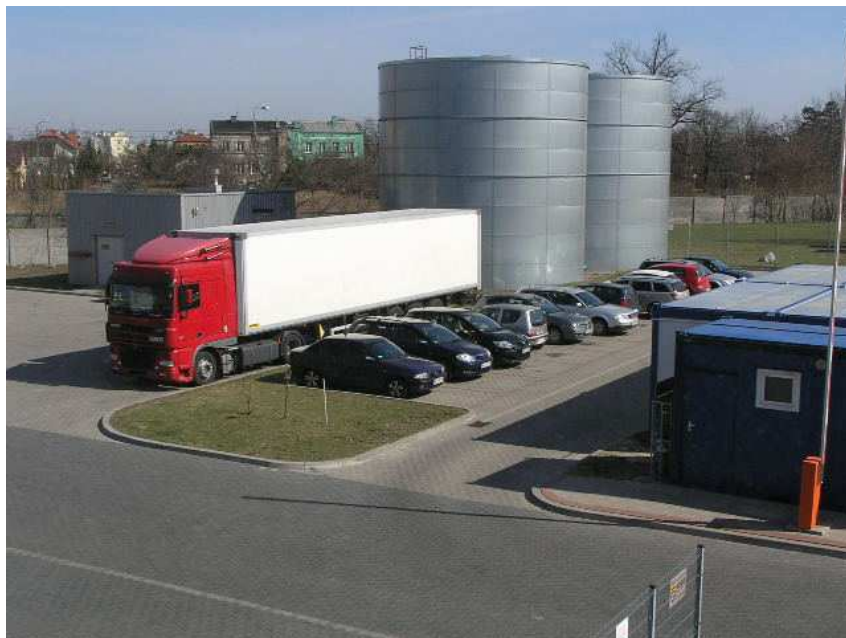
*Infrastruktura Emitenta. Na zdjęciu stacja pomp przeciwpożarowej instalacji tryskowej wraz ze zbiornikami wody.
